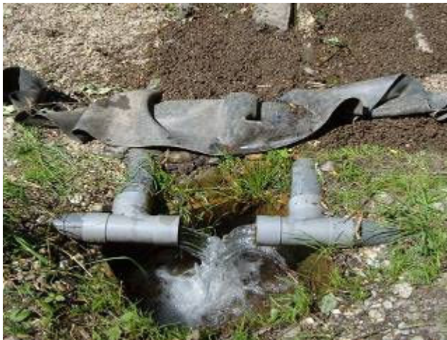
Bassin de traitement du \text{NH}_4^+ en fonctionnement
